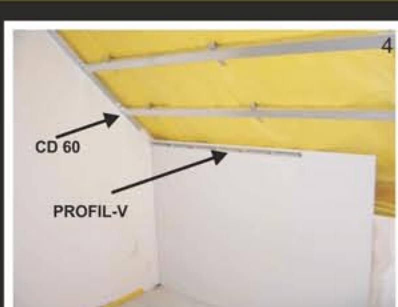
4. PO ZAMONTOWANIU PROFILU -V W POZIOMIE WKRETAMI FS DO ODCINKÓW CD 60 - WYTYCZAMY SKOS. MAX ODLEGŁOŚĆ PIERWSZEGO PROFILU CD 60 OD PROFILU-V 400MM
